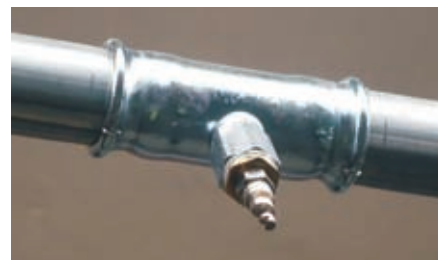
Dysza mgłowa ma specyficzną konstrukcję
