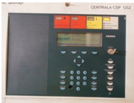
Centrala sygnalizacji pożaru
