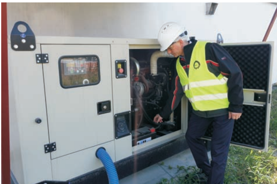
Awaryjne zasilanie - agregat prądowórczy
